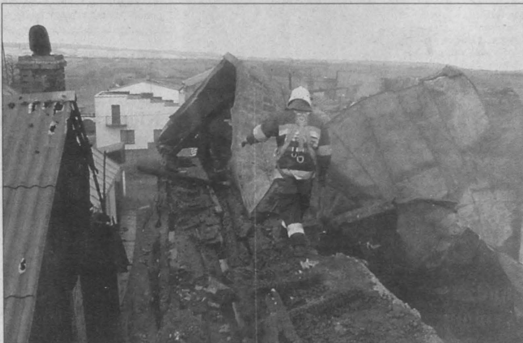
Widok na spalone, zawalone dachy.
